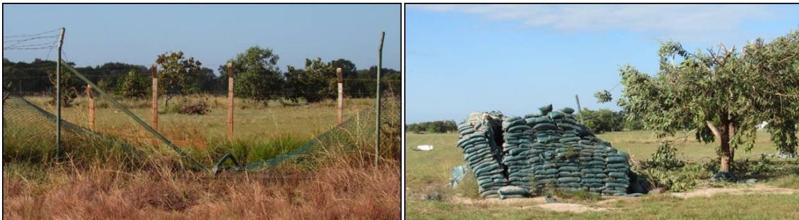
Fotografía No. 1: Daños en la cerca perimetral del aeropuerto, garita y árbol
